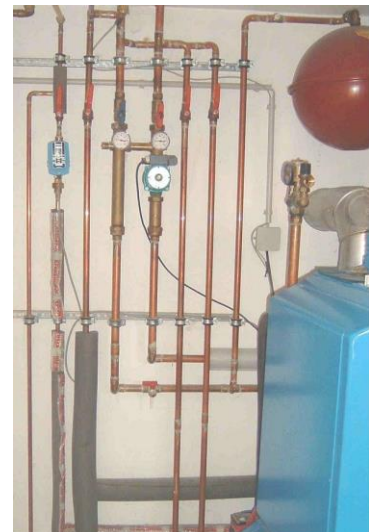
Ungedämmte und unzureichend gedämmte Rohrleitungen sind nicht nur verantwortlich für Energieverluste, sondern können auch Bußgelder nach sich ziehen oder erzeugen Legionellen-Bildung
